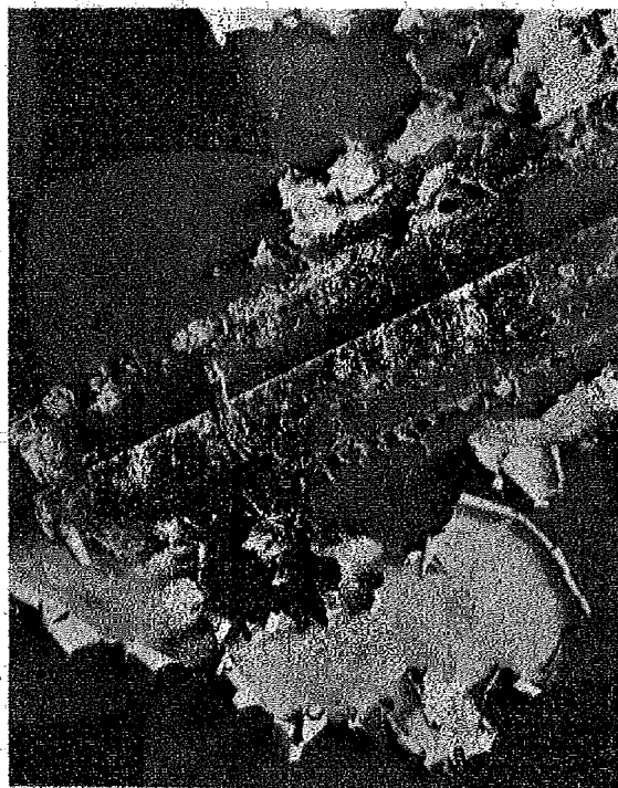
Fig. 12. Betonbælvning med afskallende Oliemaling i et Rum i Fortet paa Provoststenen. Bælvningen er nu tør, men tidligere er Vandet trængt ind gennem en Røve i Bælvningens Top, under hvilken man har opbængt en Tagrende for at undgaa Dryp.
